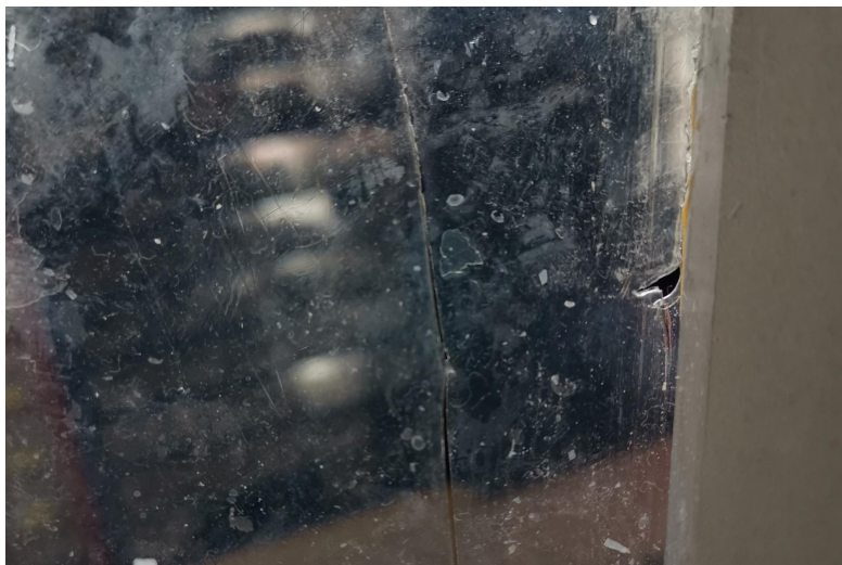
Vážené poškození FEP fólie
